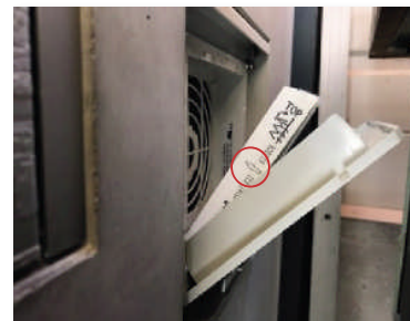
Achtung, Pfeil muss nach Innen zeigen
