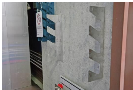
Les deux supports de fusibles sont montés et les fusibles HT peuvent être insérés.
